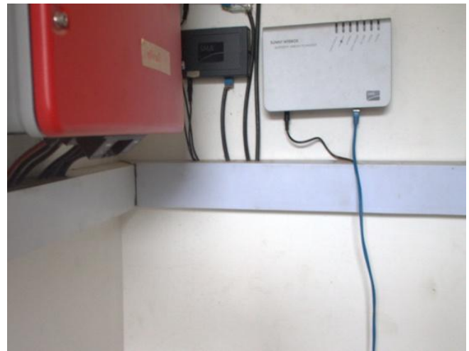
Fig. 7. SMA solar PV data logger
